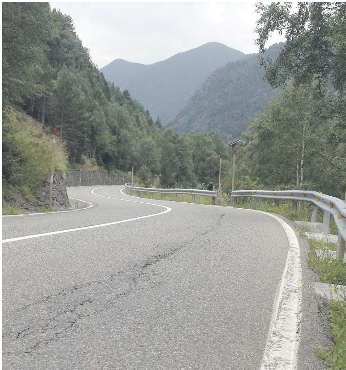
Aspecte de la carretera general 3 en un dels revolts al tram que va de Llorts a les Salines.
